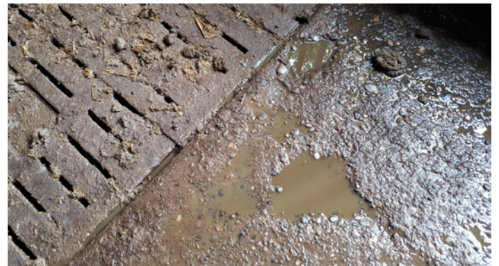
Illustr. 17: béton usé avec accumulation de liquide
