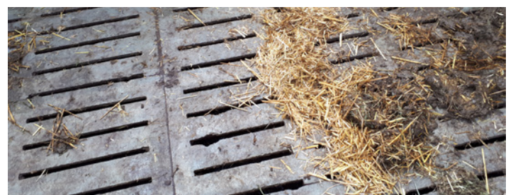
Illustr. 14: caillebotis en béton avec fentes endommagées
