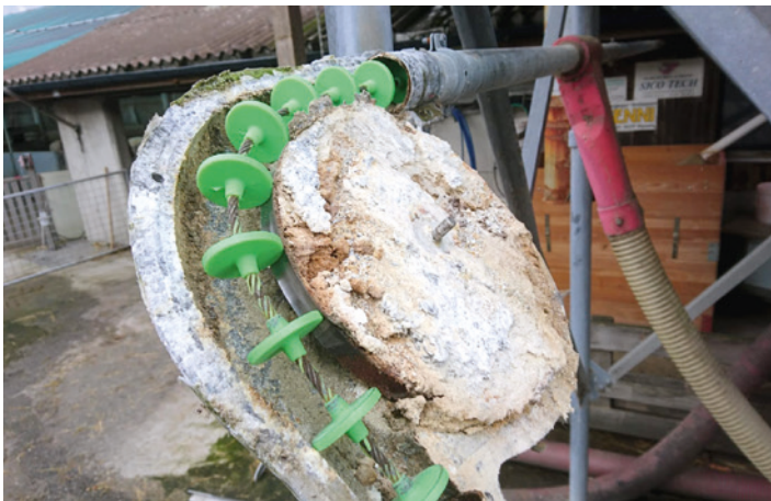
Abb. 4: Verschmutzte Umlenkrolle (Futterleitung) bei einem Betrieb mit hohen Ausfällen infolge HIS
